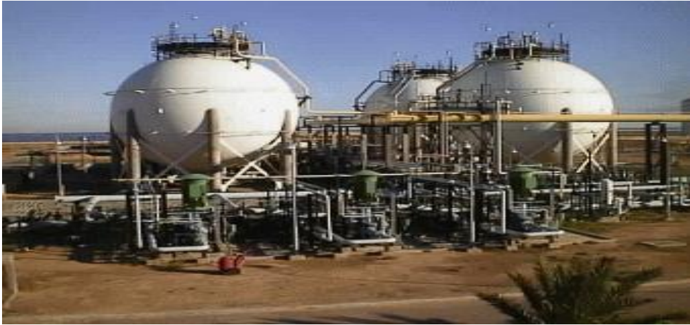
Figure III.6 : Les sphères de stockage
