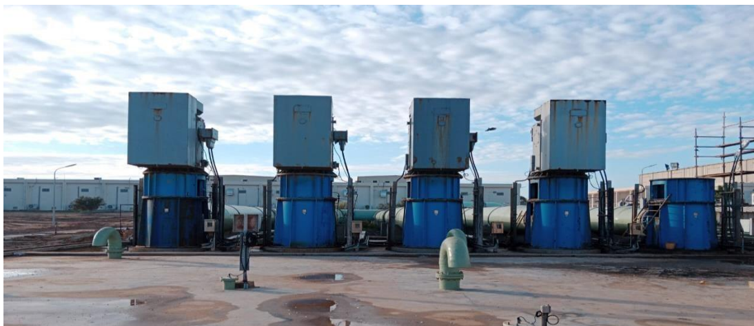
Figure 32 : Système de pompage d'eau de mer
