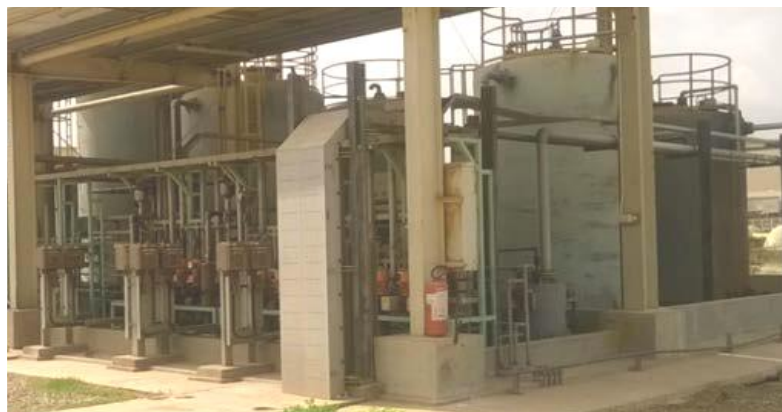
Figure 37: Réservoirs de stockage des produits chimiques.
