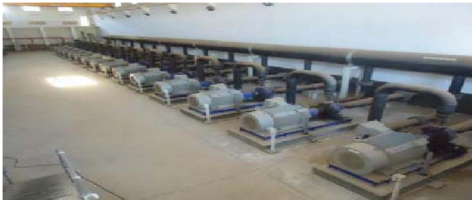
Figure 51 : Station de pompage de l'eau traitée.
