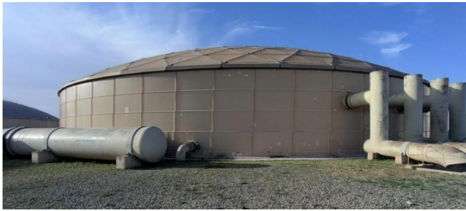
Figure 50: Réservoir de stockage de l'eau traitée.
