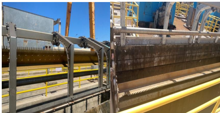
Figure 30 : Crible à barreaux CBS (coarse bar screen)
