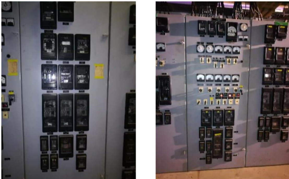
Figure III.18 : La cellule de départ TG existant.
