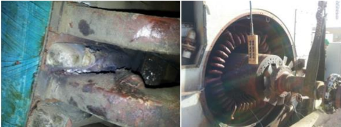
Figure II.15 : L'effet du défaut de court-circuit sur le stator du TG 2.
