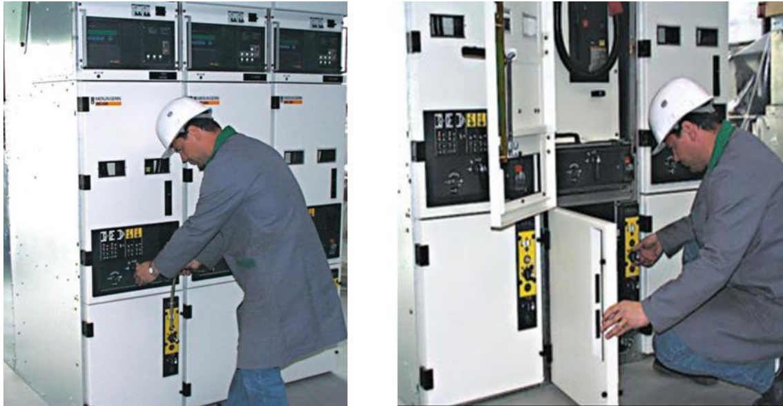
Figure III.19 : Manipulation plus sécurisée sur une armoire 5.5kv.
