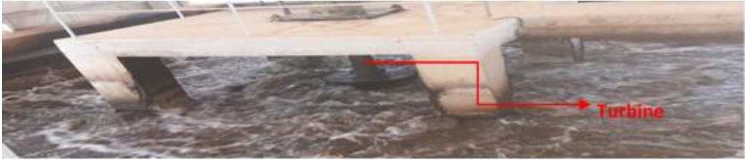
المصدر: صور محصل عليها من طرف رئيس المصلحة والمهندس الملحق 04: المرحلة الثالثة لمعالجة المياه المنزلية
