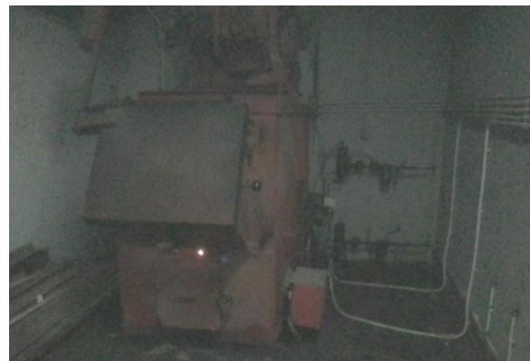
Figure III.2 : l'incinérateur de l'hôpital
