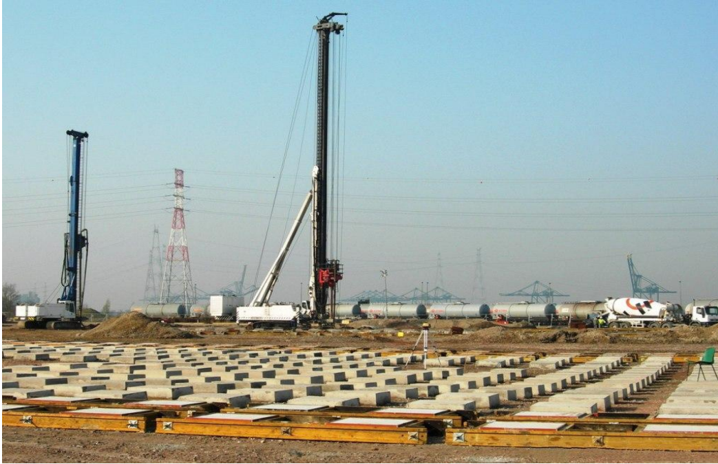
Figure I.2.3. Exemple de têtes d'inclusion carrée. Réservoirs pétroliers pour l'usine pétrochimique Oil Tanking, Belgique 2008 [1].
