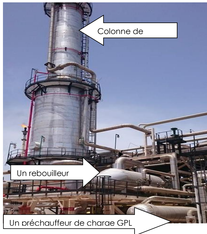
Figure I.6 : la section de séparation de GPL.
