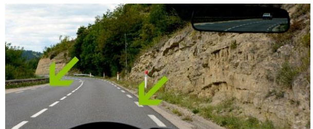
Fig. 36 : Ligne de rive
