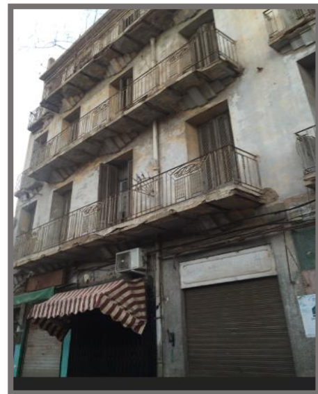
Figure 92: Façade d'un immeuble de rapport en mauvais état sur l'axe Mohamed el kébir. Source : Auteurs.
