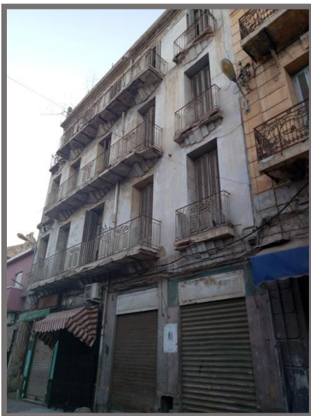
Figure 53: un immeuble de rapport datant de l'époque coloniale dans un état vétuste et abandonné par les habitants propriétaires. Source : auteurs
