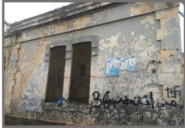
Figure 94: état de la peinture et des enduits de la façade de l'ex-école pasteur. Source : Auteurs.
