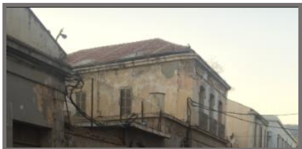
Figure 90: Toiture de l'ex-Ecole Pasteur. Source : Auteurs.
