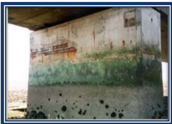
Figure 8: l'humidité qui affecte le béton
