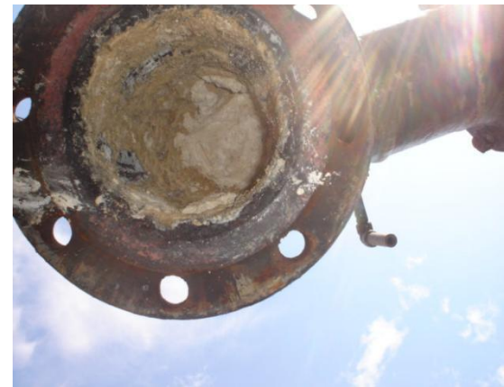
Figure II.2 : Images du problème de Bouchage de l'échangeur
