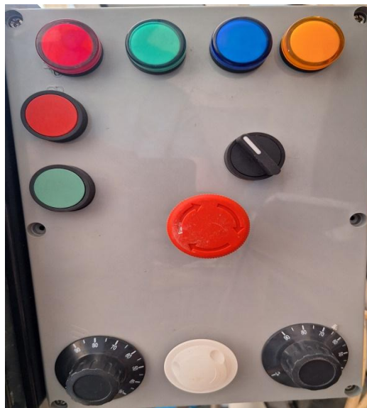
Figure III.13 : Etat du panneau de contrôle câblé
