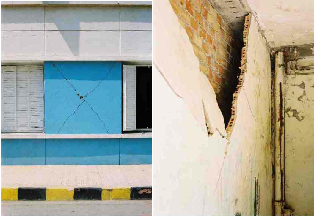
Photo 6: hôpital de Dellys 1950 (rapport du séisme 24 mai 2003 AFPS )
