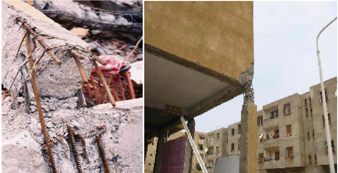
Photo 2: ossature poteaux-poutres récents en béton armé endommagé séisme (mai 2003)
