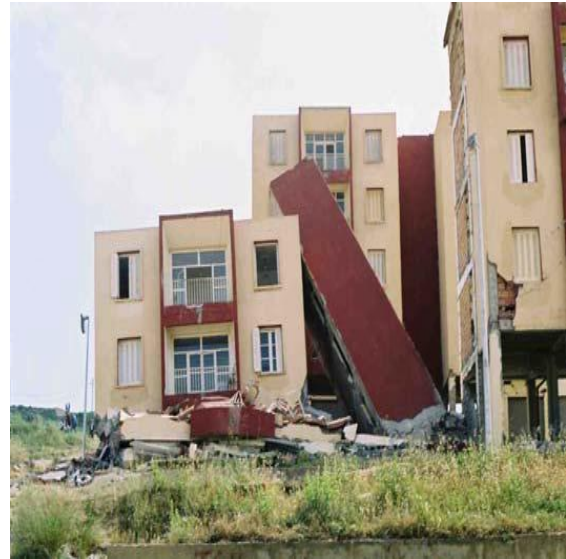
Photo 4: L'immeuble R+4 avec défaut de conception
