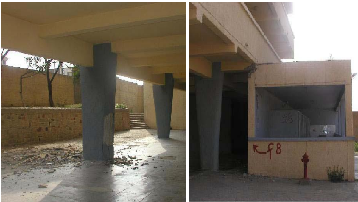
Photo 5: Endommagement scolaire (rapport du séisme 24 mai 2003 AFPS )
