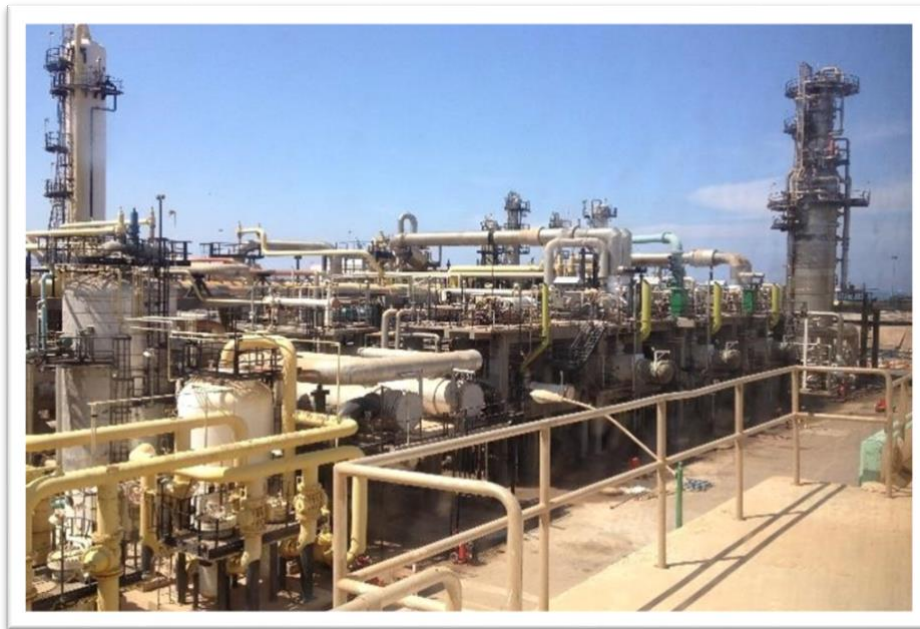
Figure 4: Complexe de liquéfaction du gaz naturel « SONATRACH – GL3/Z »
