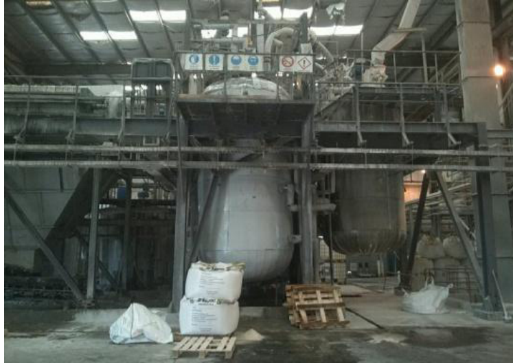
Figure I.3 : Unité de silicate de sodium
