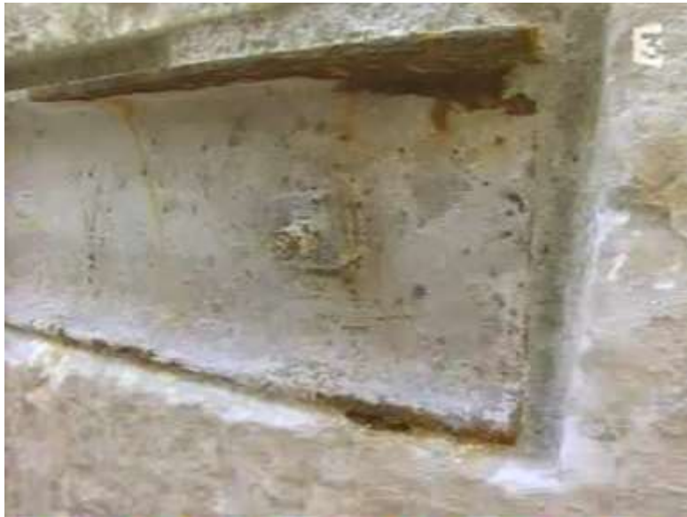
Figure 24 : Une barre de fer fixée dans le marbre de l'architrave en 1931 par Balanos
