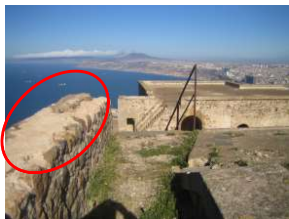
Figure 23 : Le parapet restauré en négligeant les pièces d'origine Source : auteur du mémoire
