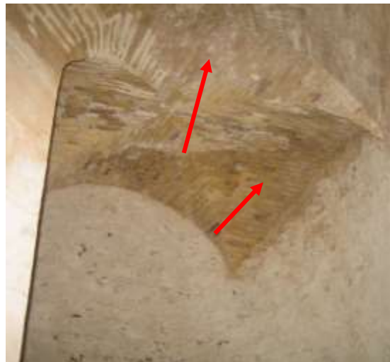
Figure 27 : Disparition de quelque joint après la restauration
