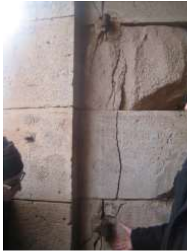
Figure 19 : éclatement du marbre
