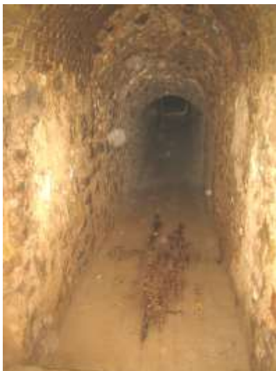
Figure 30 : Infiltration dans la galerie de 12mètre
