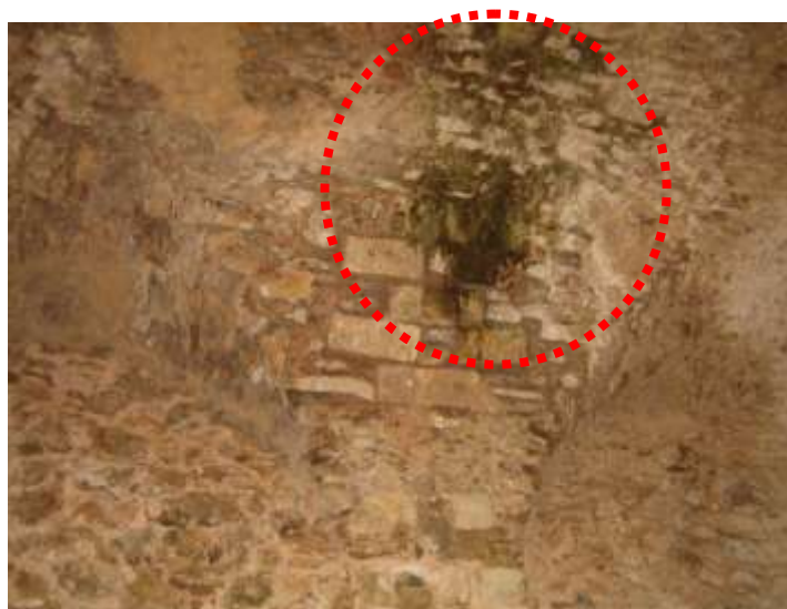
Figure 4 : Prolifération des lichens (moisissures) sur la voute après l'intervention de restauration
