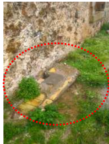
Figure 31 : Stagnation des eaux pluviales dans la place d'arme
