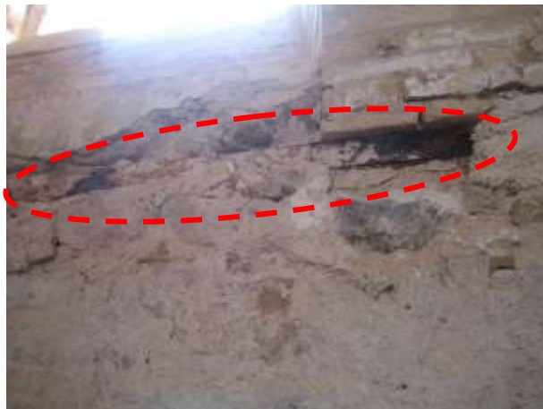
Figure 24 : Eclatement des pierres le long de la barre de fer rouillée
