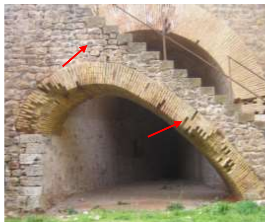
Figure 16 : dégradation des joints
