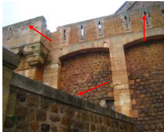
Figure 11 : Salissure noire (acide acétique et de poussière) sur les éléments saillants, le haut des murs
