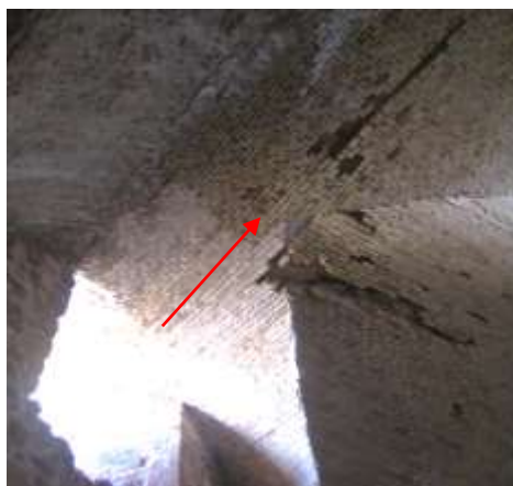
Figure 12. B : Dégradation des voutes après leur restauration et réapparition des efflorescences
