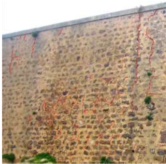
Figure 10 : fissuration du mortier
