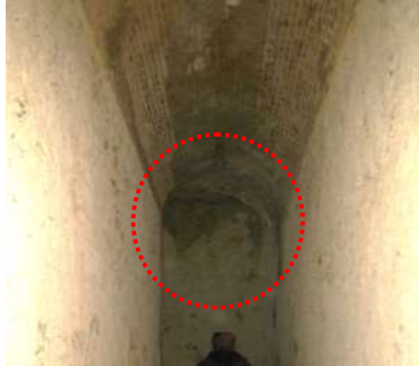
Figure 26 : Infiltration des eaux pluviales dans la poudrière après la restauration
