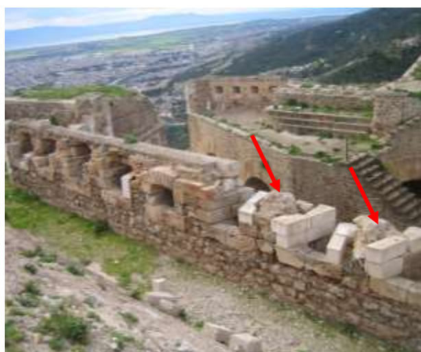
Figure 25 : restauration inachevée des meurtrières du parapet
