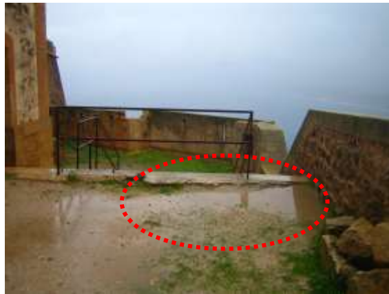
Figure 5 : Stagnation des eaux pluviales dans la deuxième terrasse
