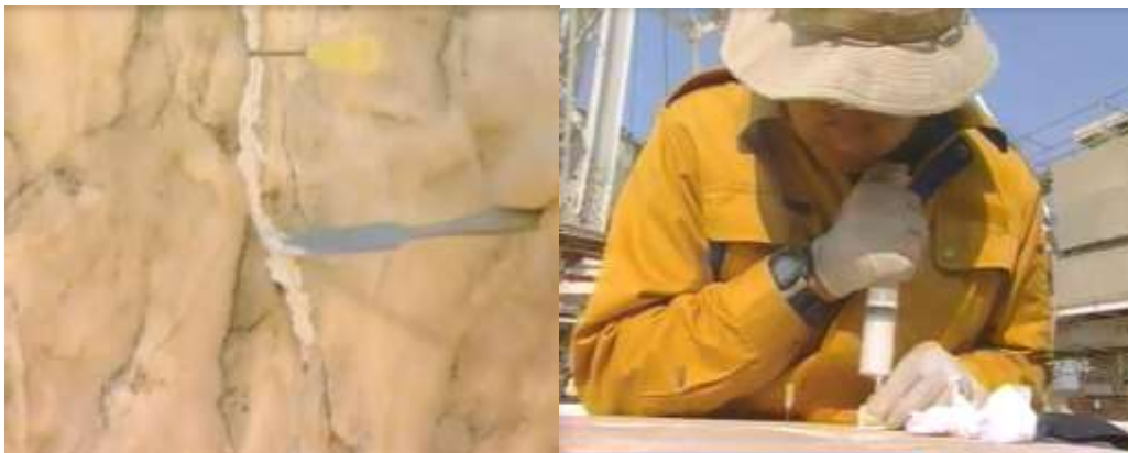
Figure 25 : Colmatage extérieur et injection du ciment blanc
