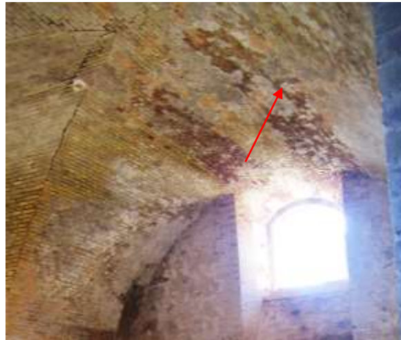
Figure 12. A : Dégradation des voutes après leur restauration et réapparition des efflorescences
