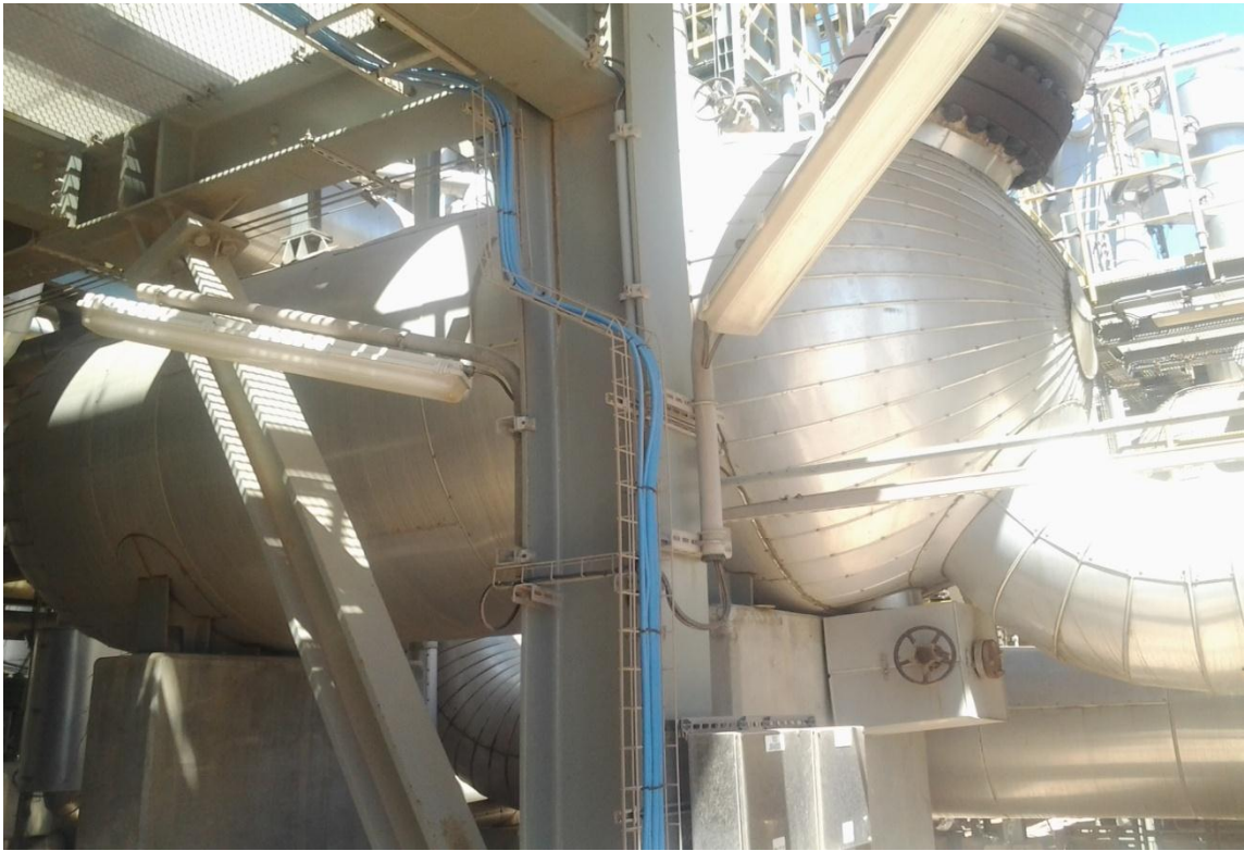
Figure III.6 : L'échangeur de chaleur 104E001 Une description détaillée de l'échangeur 104E001 se trouve dans l'annexe B.
