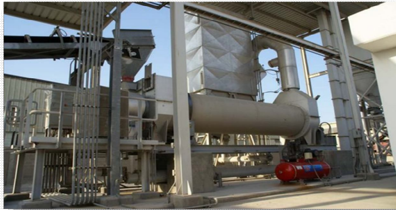
Figure IV.7 : Sécheur rotatif du sable lavé à l'unité ADWAN de Fornaka (Mostaganem)
