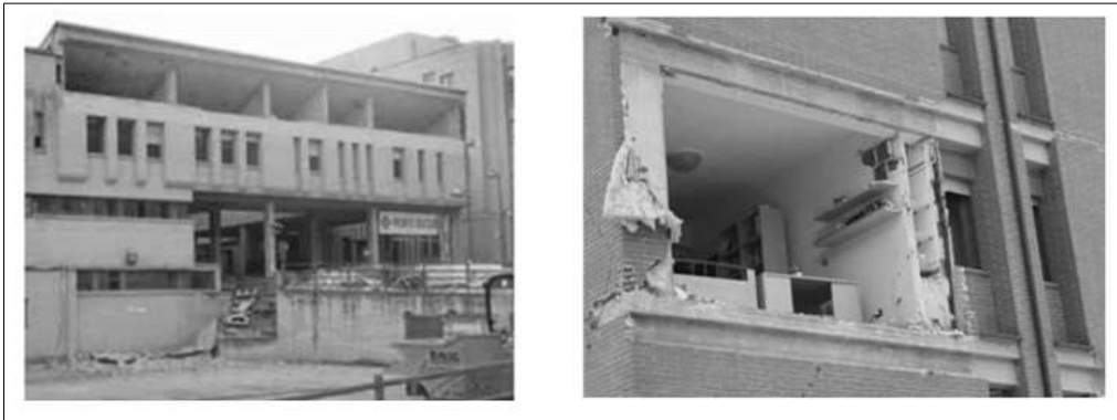
Figure I.8 Dommages dus aux éléments non structuraux (AFPS & Algerien, 2003)
