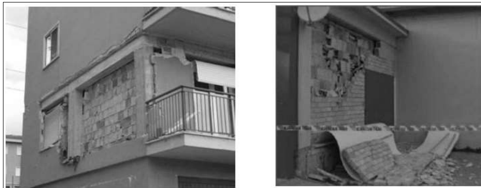
Figure I.9 Détachement des parties dans les murs à double parois (AFPS & Algerien, 2003)
