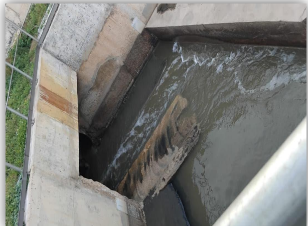
Figure I-3. L'entrée des eaux usées.
