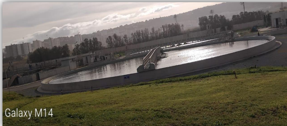
Figure I-7. Décanteur secondaire (clarificateur)
