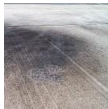
Figure II.15 : écaillage avec un niveau de gravité léger
