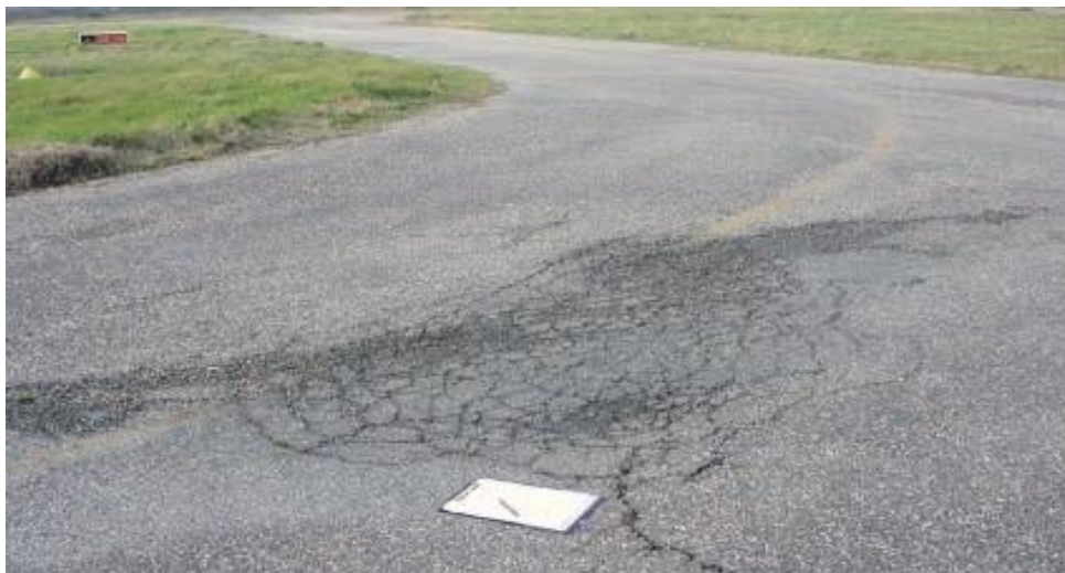
Figure II.5 : Faiçonnage de fatigue (niveau de gravité moyen)(STAC,2007).
