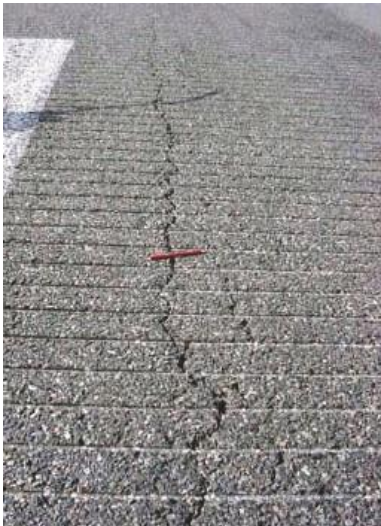
Figure II.3 : Fissure de fatigue (niveau de gravité léger) (STAC, 2007)
