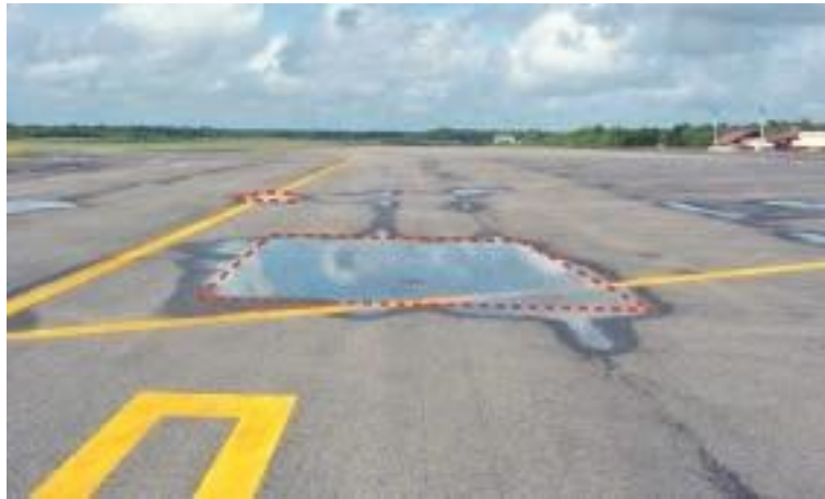
Figure II.1 : Flaches sur voie de circulation (STAC, 2007)
