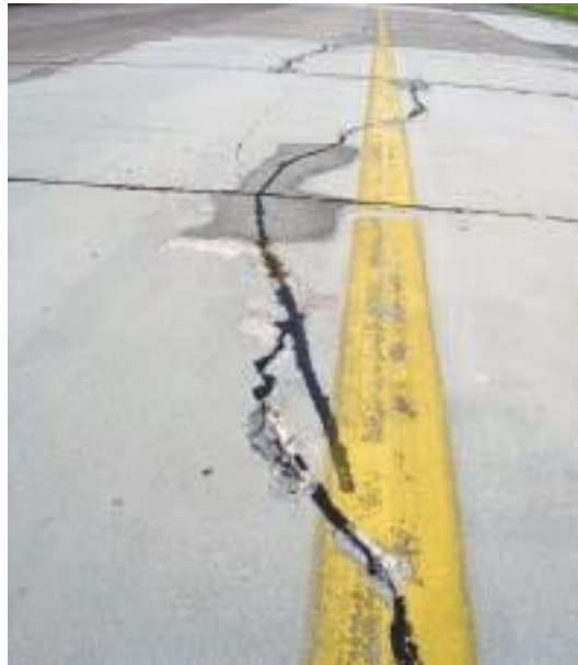
Figure II.11 : fissure avec niveau de gravité élevé
