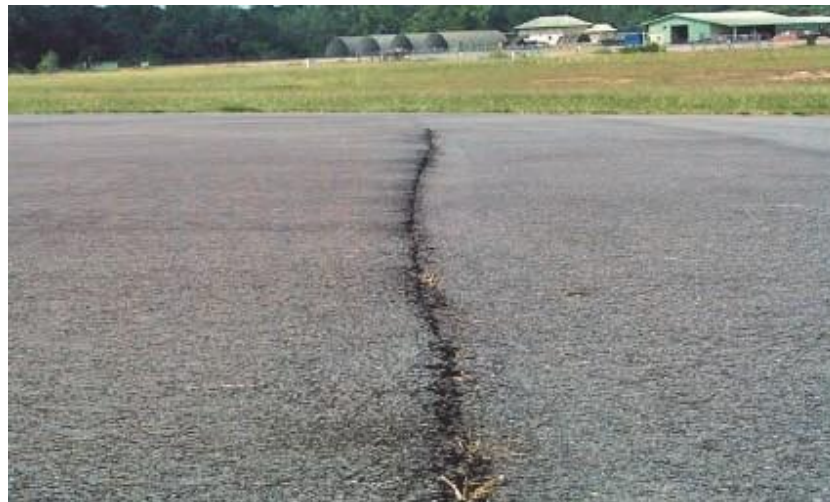
Figure II.7 : Fissure de joint entre deux bandes de répannage (niveau de gravité léger).
