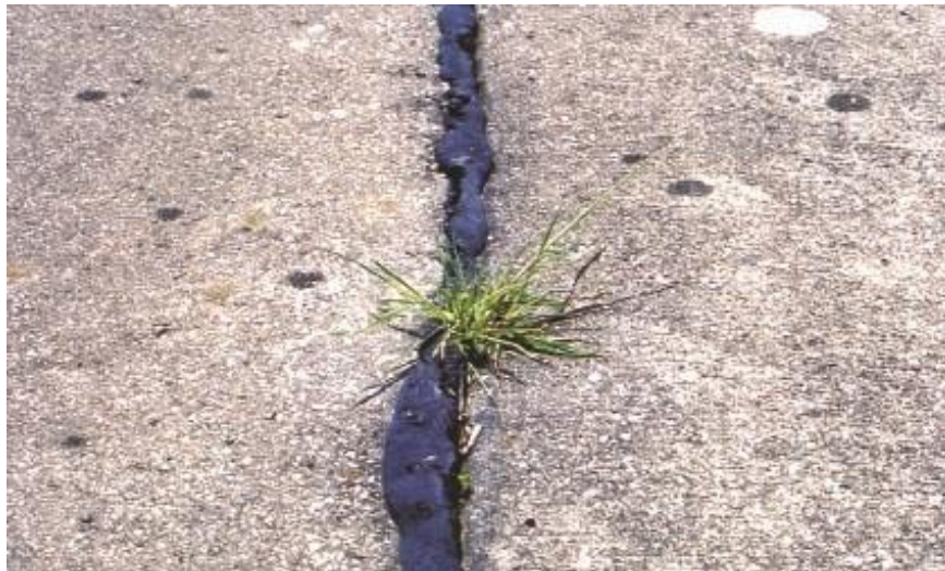
Figure II.17 : Défaut de joint (mauvaise adhérence révélée par la présence de végétation).
