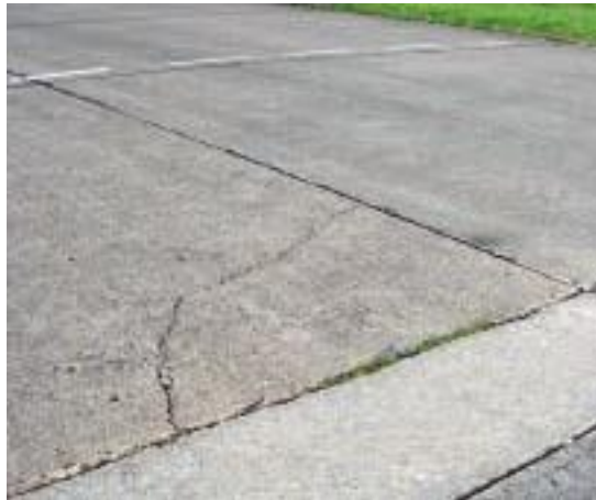
Figure II.12 : fissure en coin avec niveau de gravité léger
