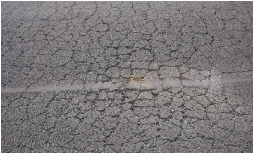
Figure II.6 : Faiençage de fatigue (niveau de gravité élevé)(STAC,2007).
