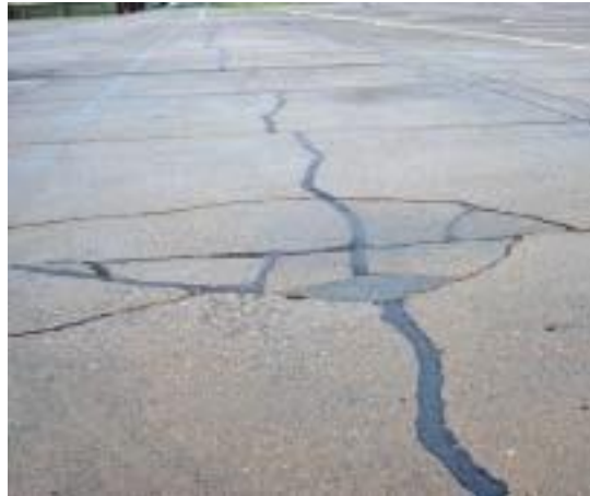
Figure II.13 : fracture avec niveau de gravité élevé
