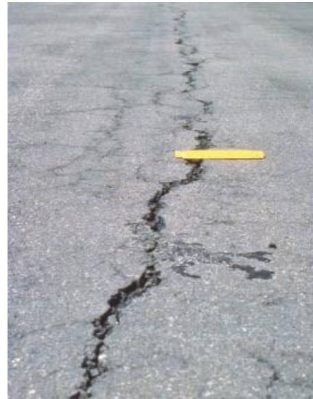
Figure II.4 : Fissure de fatigue avec départ de matériaux (niveau de gravité élevé)
