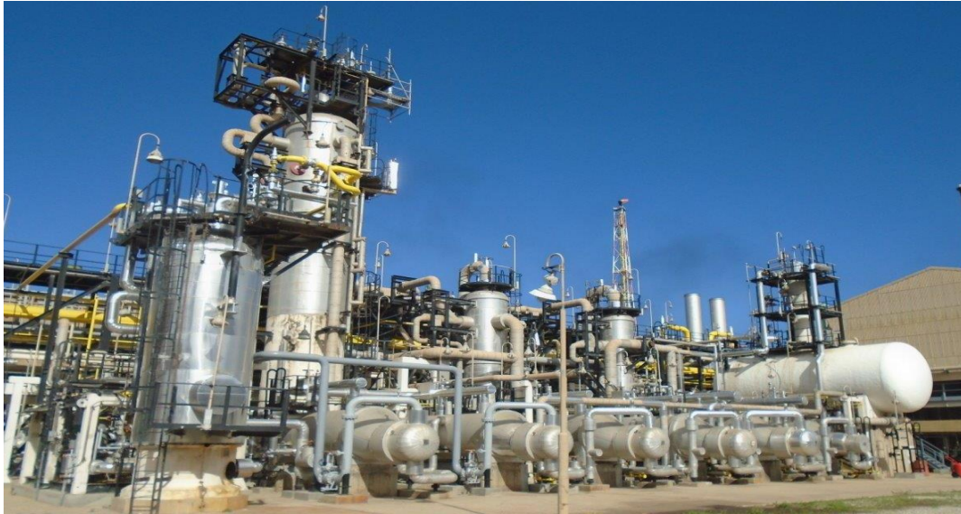
Figure I.4 Les équipements de la section de réfrigération
