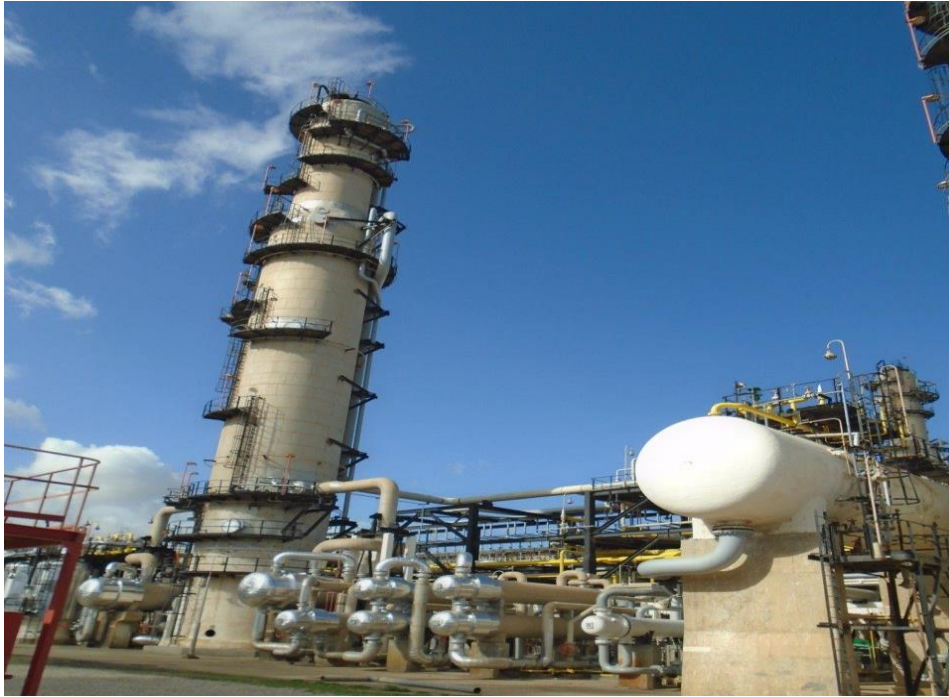
Figure I.3: colonne de séparation (Fractionnateur)
