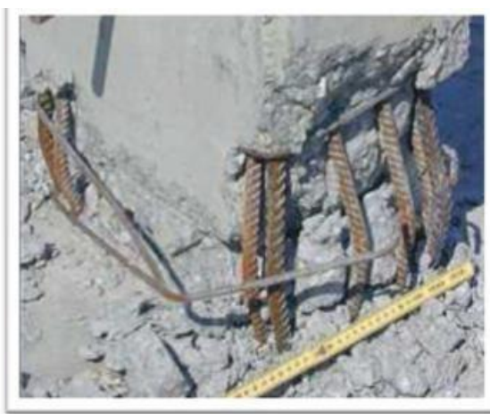
Figure 1.12. Éclatement du béton et flambement des armatures à la base
