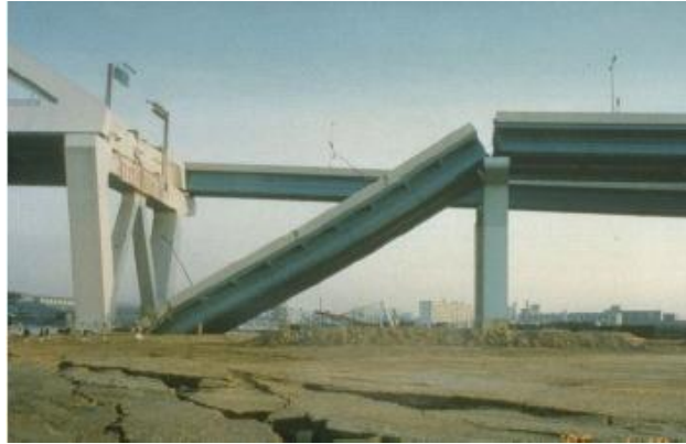
Figure4-3 :Chute du tablier lors du tremblement de terre.
