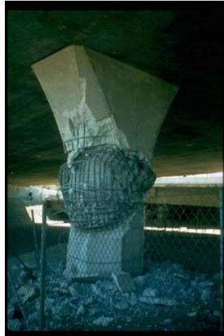
Figure4-4 :Chute d'appuis de pont lors du tremblement de terre.
