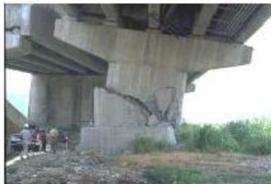
Figure4-5 : Rupture des piles par cisaillement lors du séisme.
