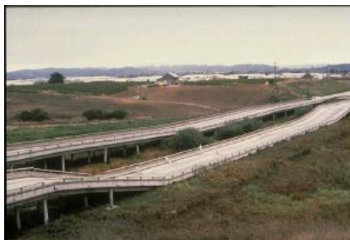
Figure 4-6 : tassement différentiel des piles d'un pont route.
